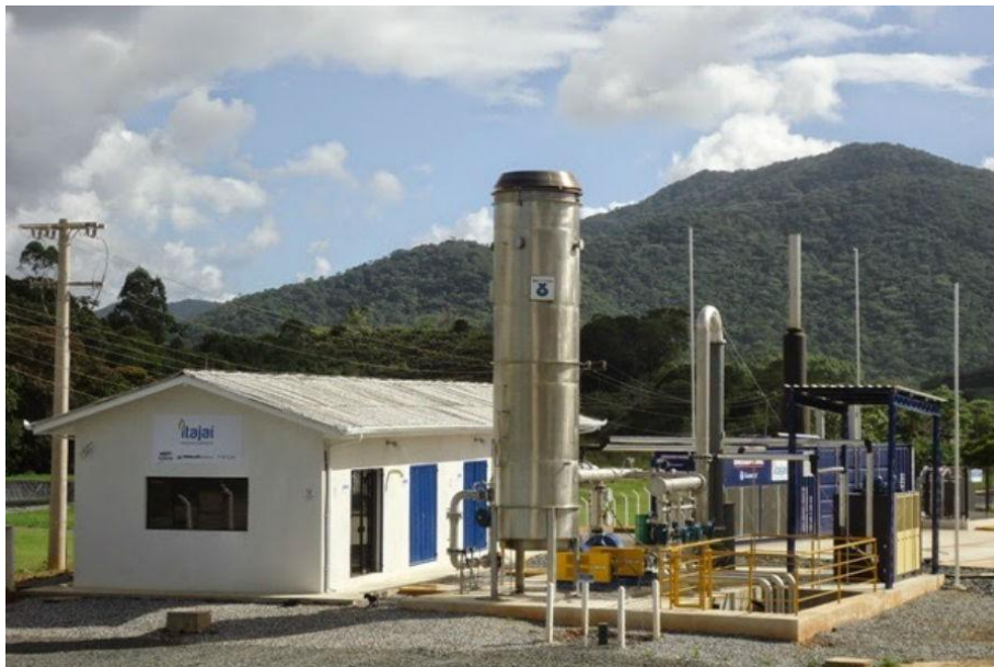
Figura 47 – Usina de Energia do Aterro Sanitário da Canhaduba – Itajaí, SC Fonte: Vieira (2014)
